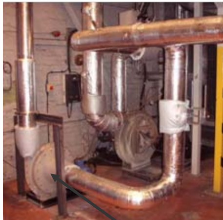
Flue Gas Recycle Fan
