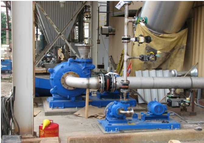
Recirc & Bleed Pumps
